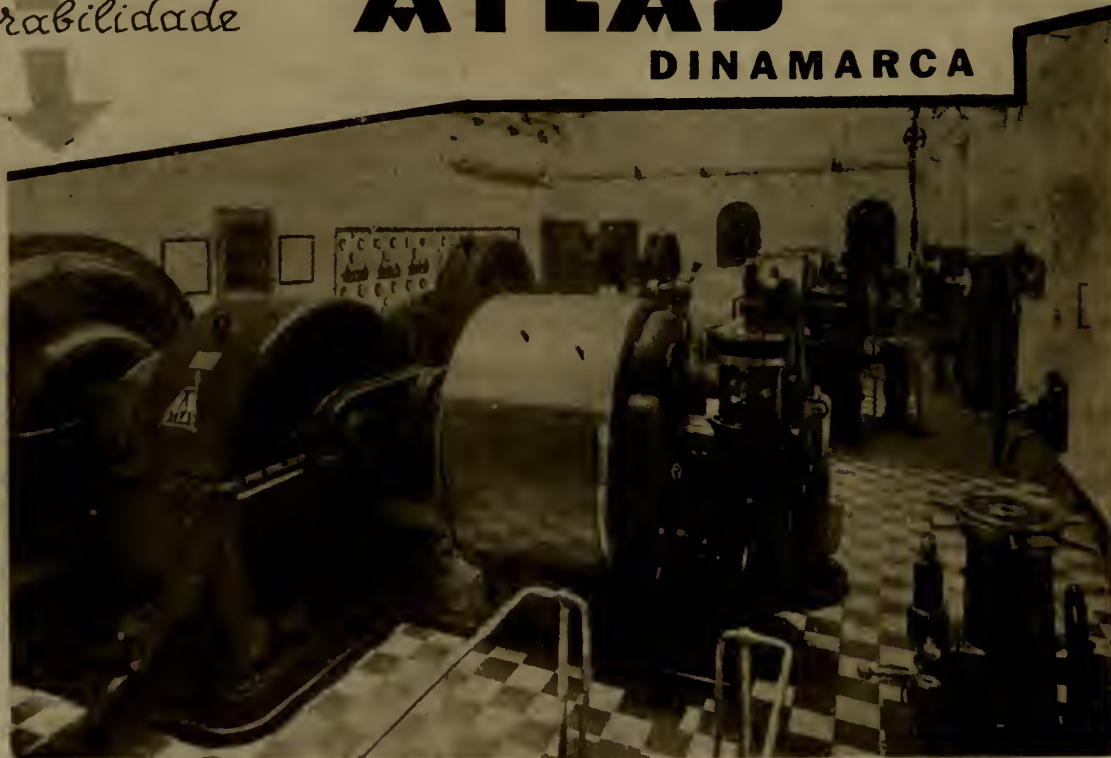
4 Turbinas ATLAS de contrapressão, acionando 4 geradores de 2.200 KW numa grande usina de açúcar.
