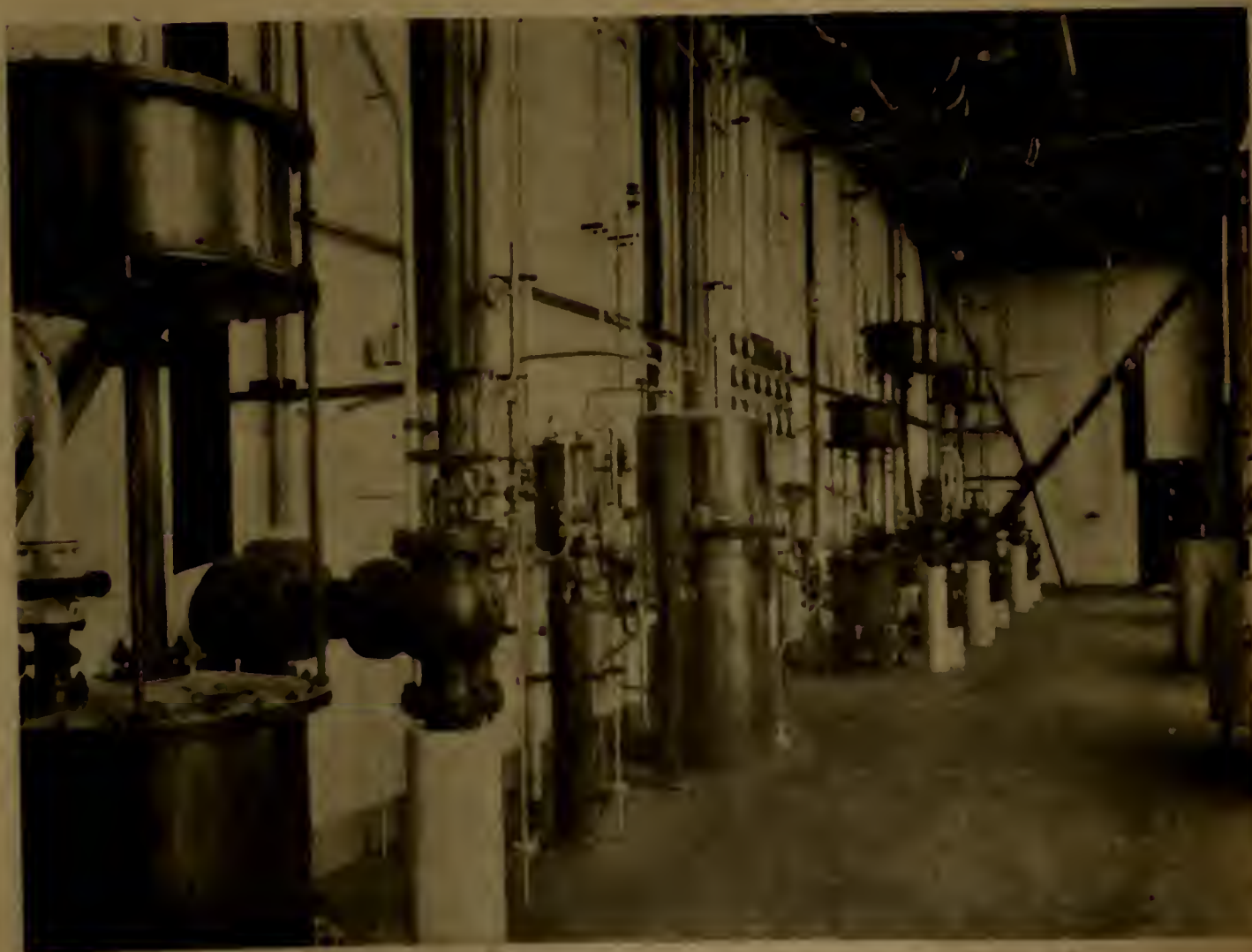
Reguladores de vapor, aparelhos de controle das colunas de destilação
