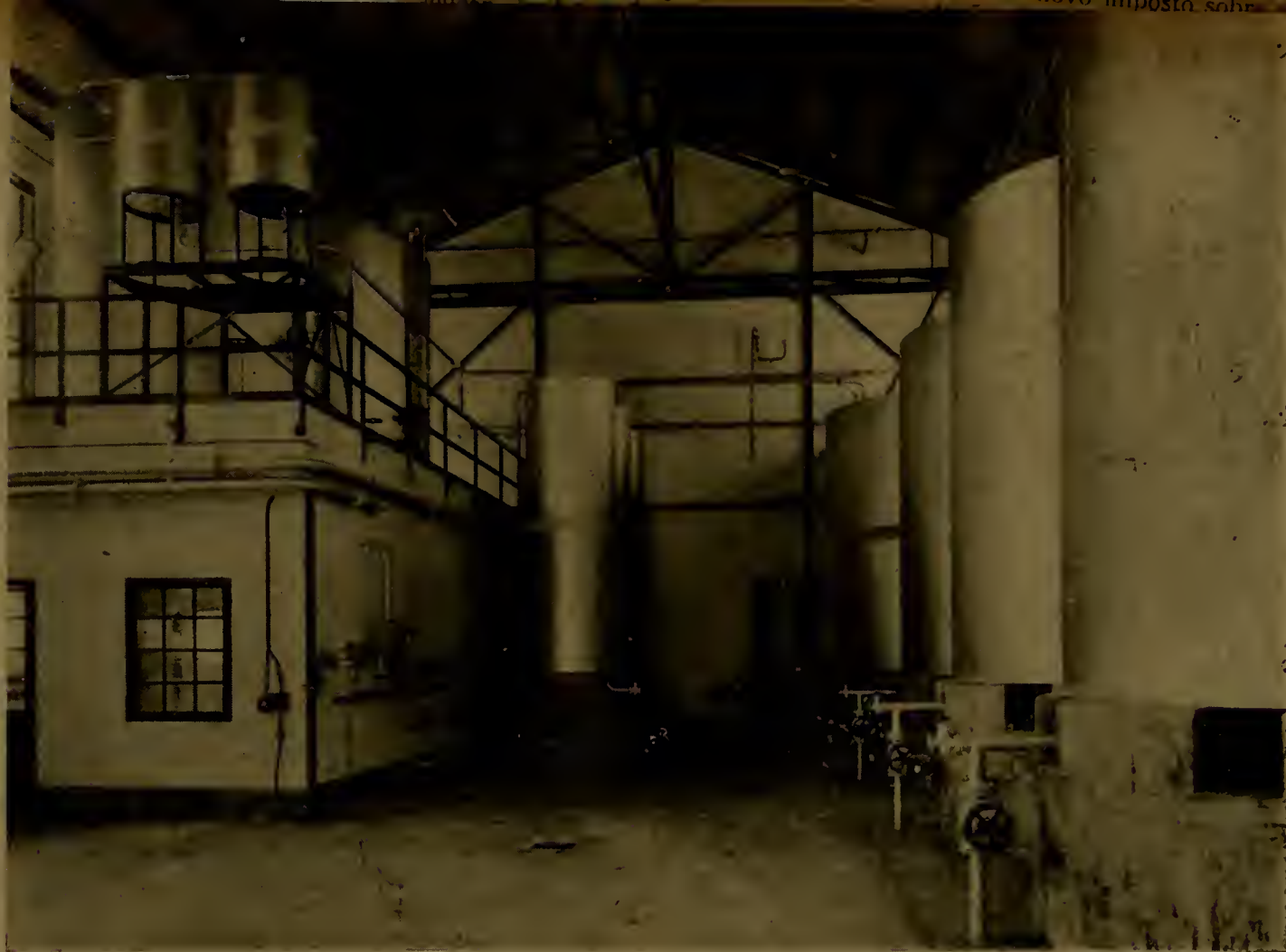
Tanques de álcool — Secção de enchimento de toneis
