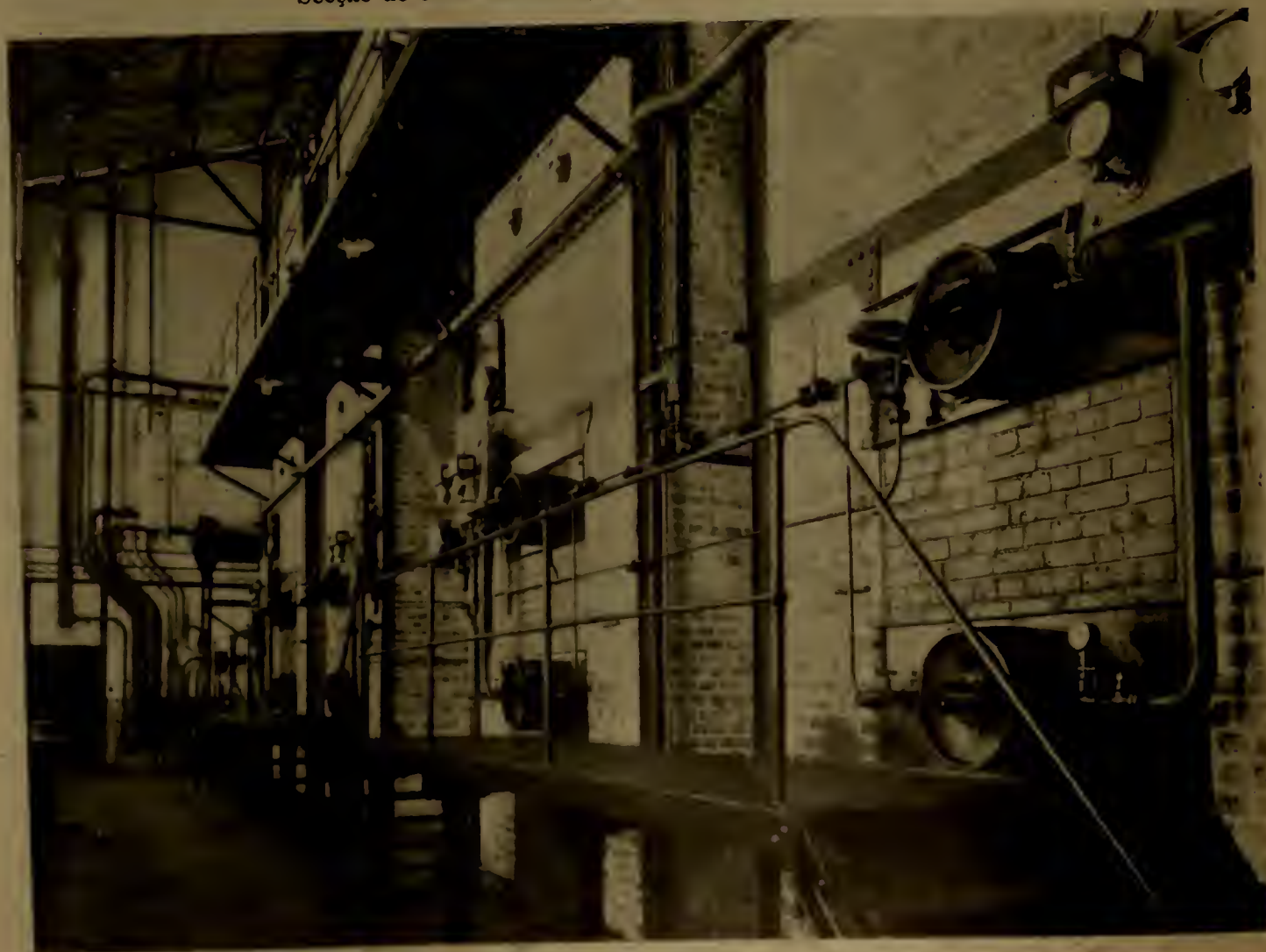
Secção de caldeiras — Queimadores de óleo e aparelhos de controle
