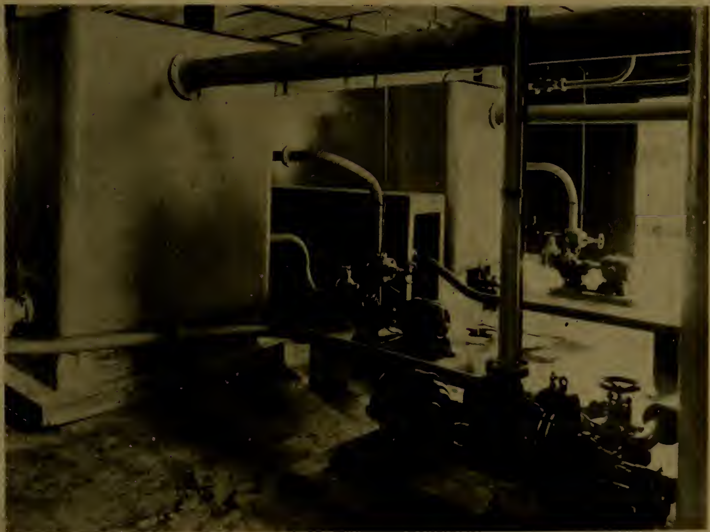
Secção de bombas
