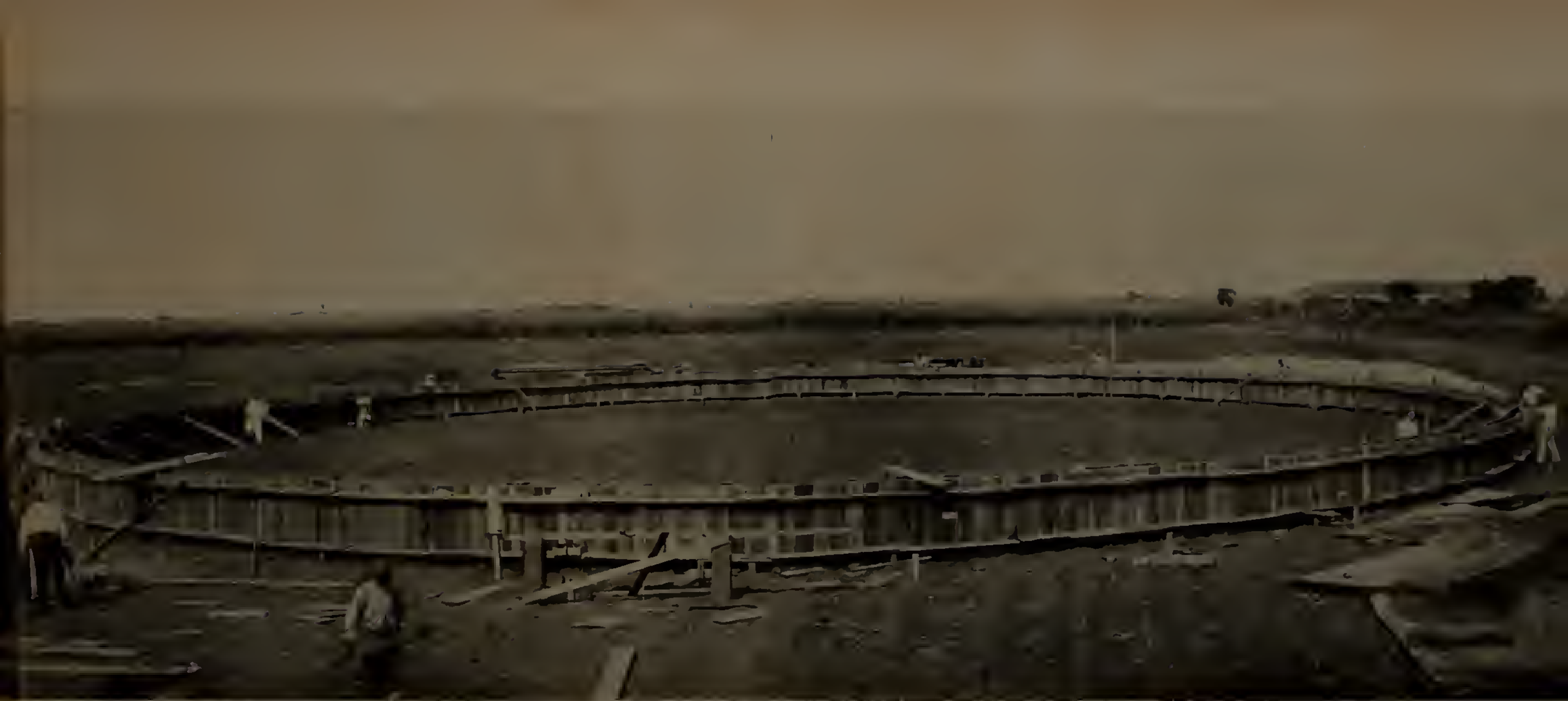
Aspecto das fundações iniciais do tanque de melão, podendo-se avaliar pelas proporções a extraordinária capacidade que terá a futura Distilleria que o Instituto do Açúcar e do Alcool está construindo no Município de Campos
