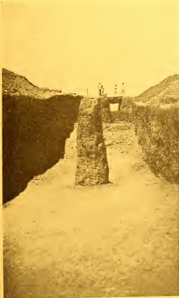
Início do côrte de 12 metros de profundidade, sobre a estrada de rodagem Iguatú - São Matheus, com o objectivo de estabelecer comunicação entre as duas primeiras lagôas superiores do sistema.
