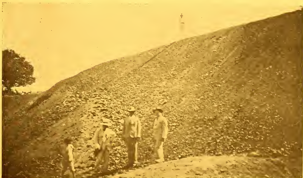
Aspecto da barragem de terra, quando em construcção, sobre o Riacho São Pedro, com o objectivo de desviar-lhe o curso - (Dezembro de 1933)
