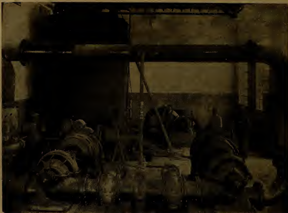
Aspecto interno das grandiosas instalações da futura Distillaria de alcool anhidro levantada pelo I. A. A. em Campos - Bombas de agua, cada uma de 700.000 litros de capacidade, por hora
