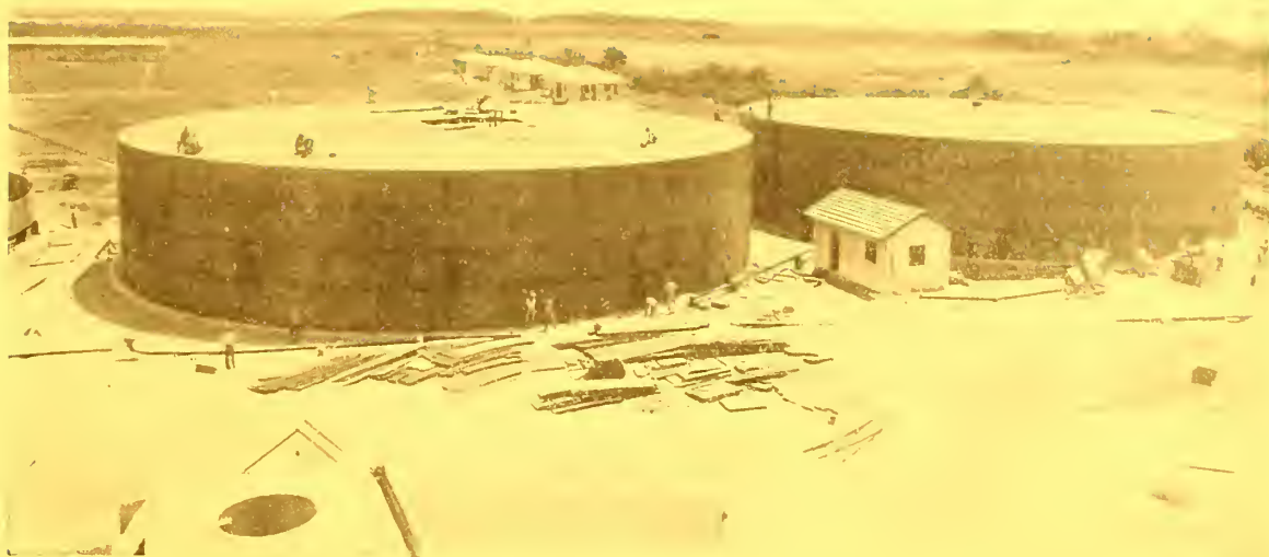
Distillaria Central de Campos (em construcção), pertencente aa Instituta da Açucar e do Alcaal. — Tanques de melaça, vendo-se, no primeira plana, a mantagem do encanamenta pravisoria do melaça
