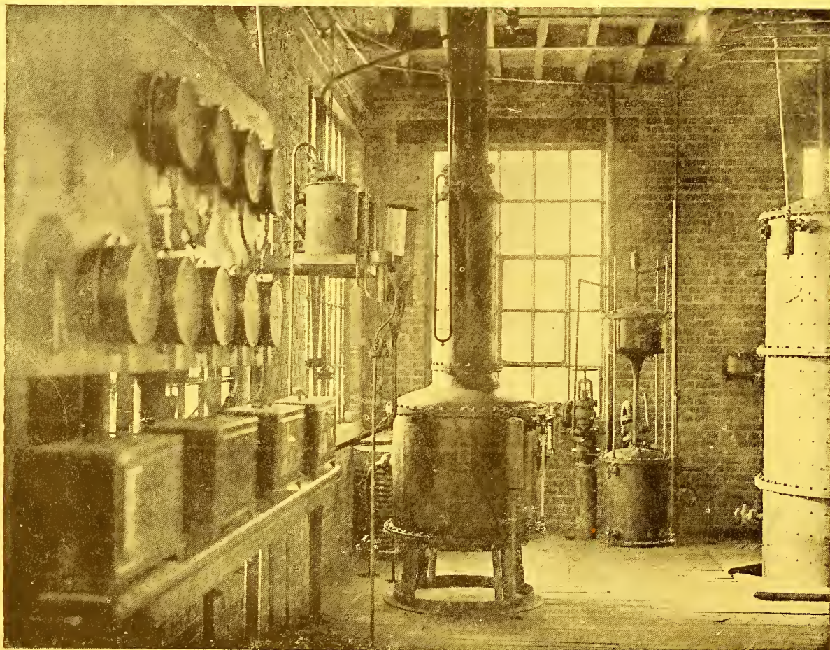
Posto de controle de uma instalação de desidrataçào azeotropica
