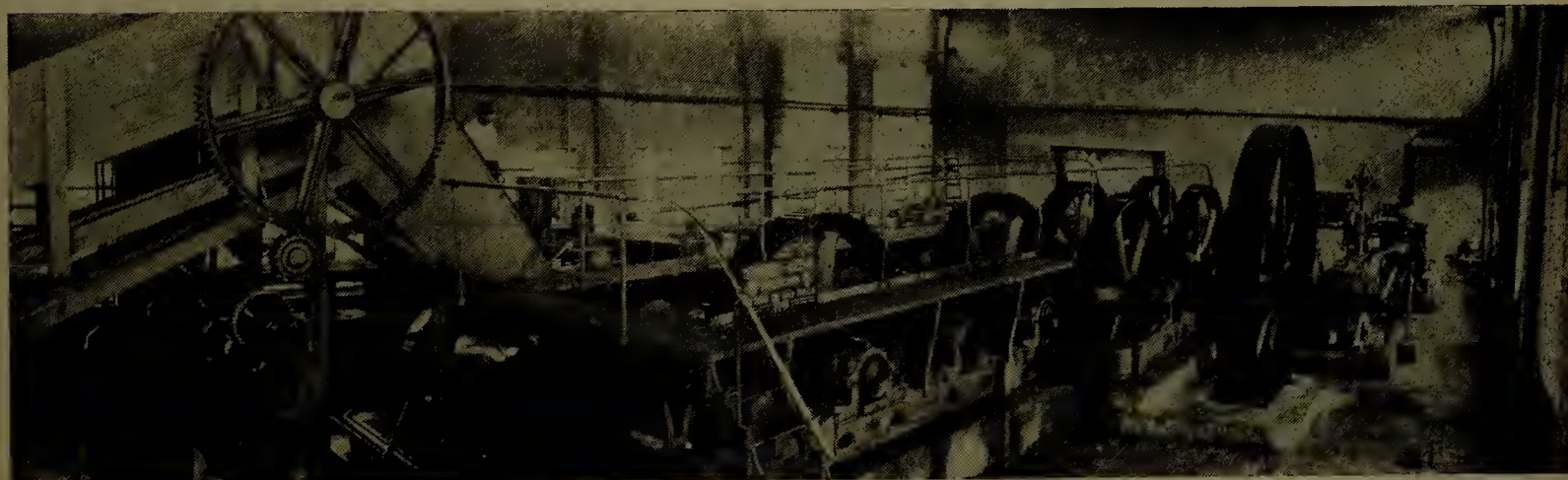
Moenda "Dedini", 4 ternos 24 x 48", instalada em 1946, na Usina "Costa Pinto" — São Paulo
