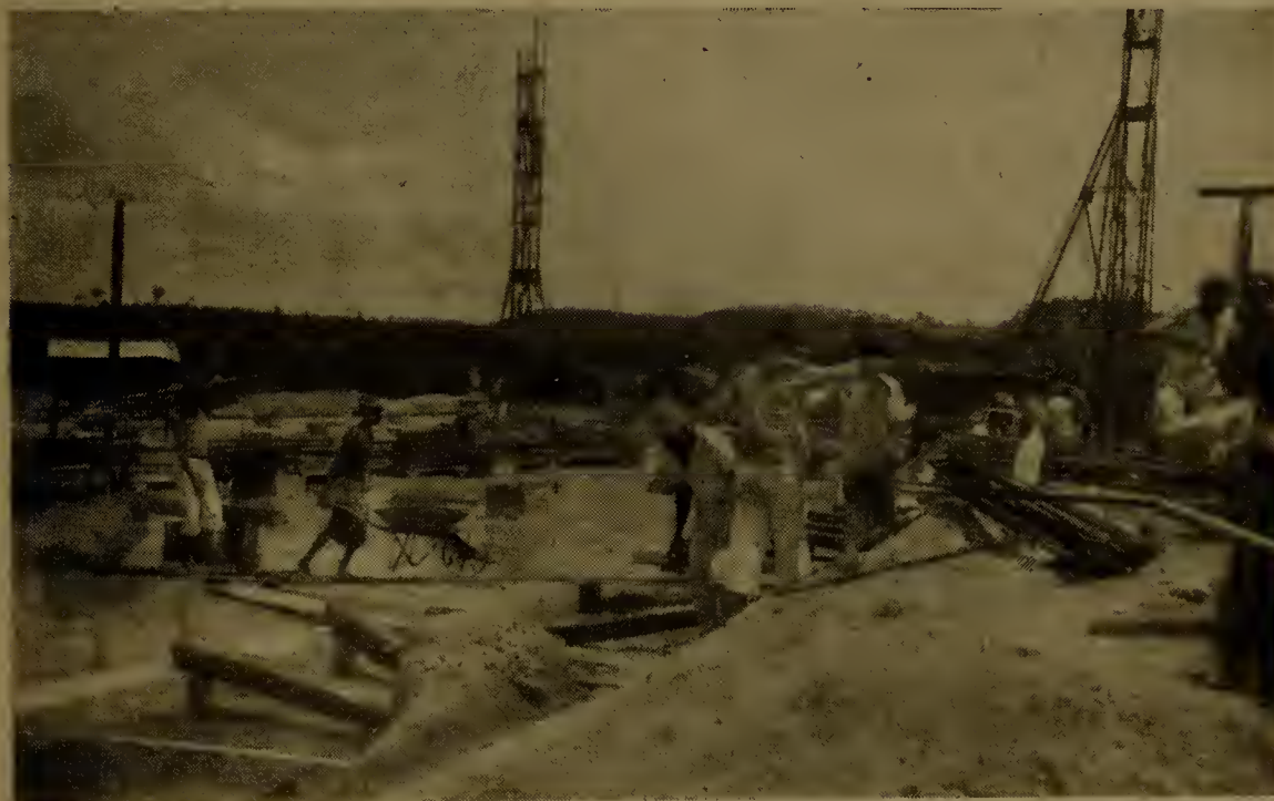
Distilaria Central de Pernambuco - Montagem do edificio de fermentaçãõ, vendo-se as torres para elevaçãõ da estrutura metalica.
