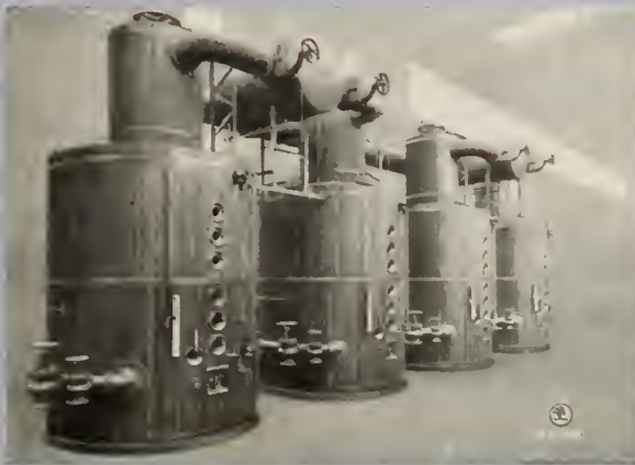
TACHOS DE VACUO INSTALLADOS NA USINA JUNQUEIRA (S. PAULO)
