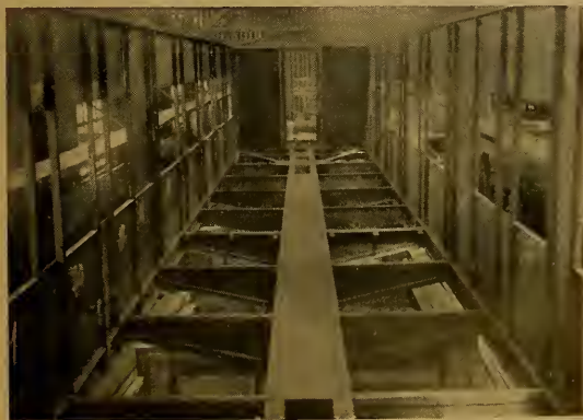
Vista interna do estrado e superestrutura de um carro de aço em construção nas oficinas de RIO GRANDE
