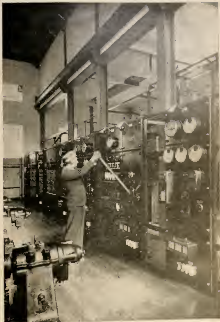
Serviço de Eletrificação — Posto de comando, na Usina d Carlos Euler
