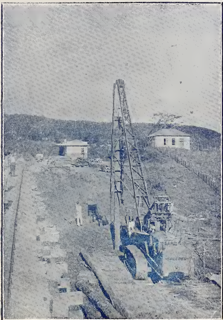
Aspecto do pátio da estação de Sergi, onde está sendo concluída a construção de um viaduto. Vem-se, também, a estação e casa do agente.
