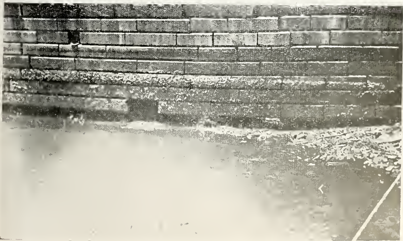
RECIFE — Trechos arruinados do cais de 10 metros
