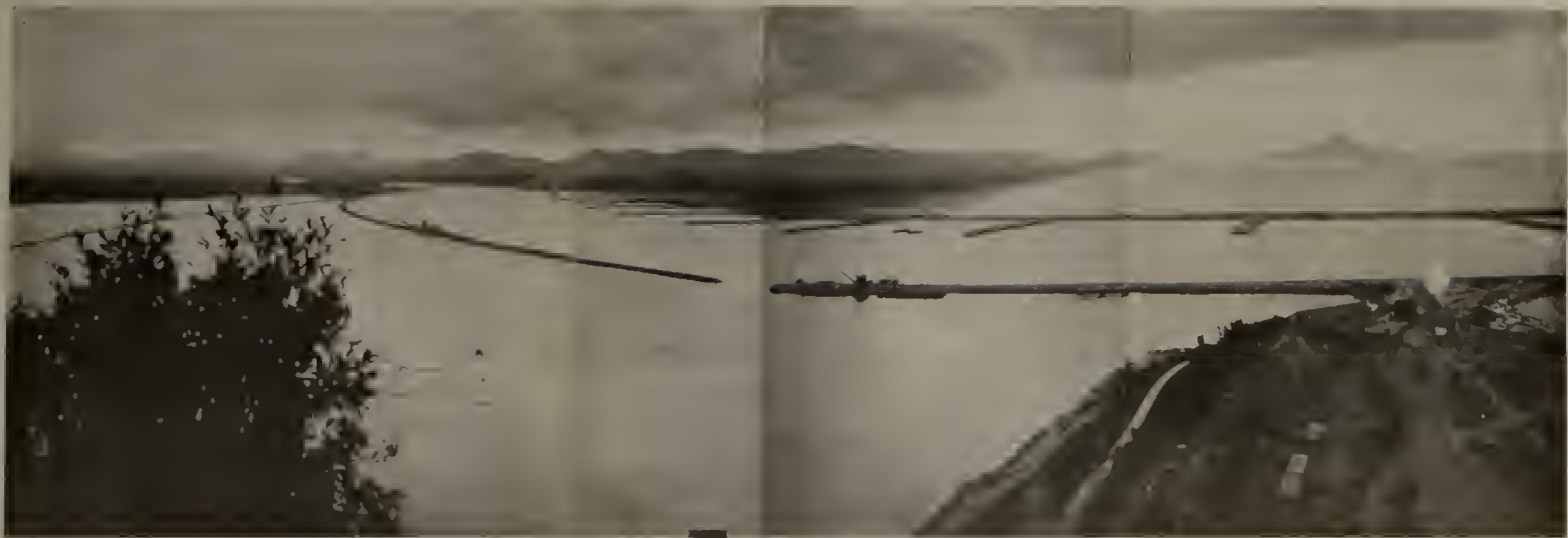
SANTA CATARINA — Pôrto de Itajaí — Sistema de obras fixas de enrocamento construídas para o aprofundamento e regularização da barra e canal de acesso ao pôrto.
