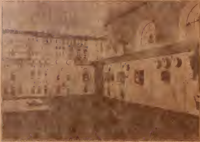
L'usine de force électrique du Camp. Installations de St. Paul. C'estes
