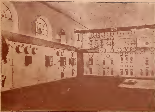
Cabina da força electrica da Comp. Melhoramentos de S. Paulo Caveiras
