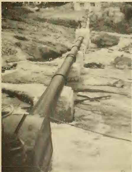
Água canalizada para as turbinas hidro-elétricas de Freixeiras — Usina Santa Terezinha
