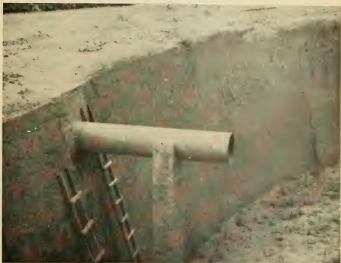
Detalhes do tanque de distribuição d'água — Usina Santa Terezinha
