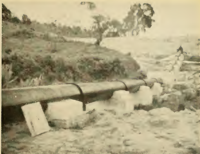
Água transportada em canos de ferro — Usina Santa Terezinha
