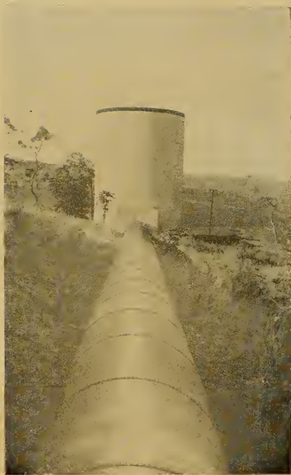
Tubulação e Castelo de equilíbrio — Usina do Lobo, da S. A. Central Elétrica Rio Claro — Itirapina — São Paulo
