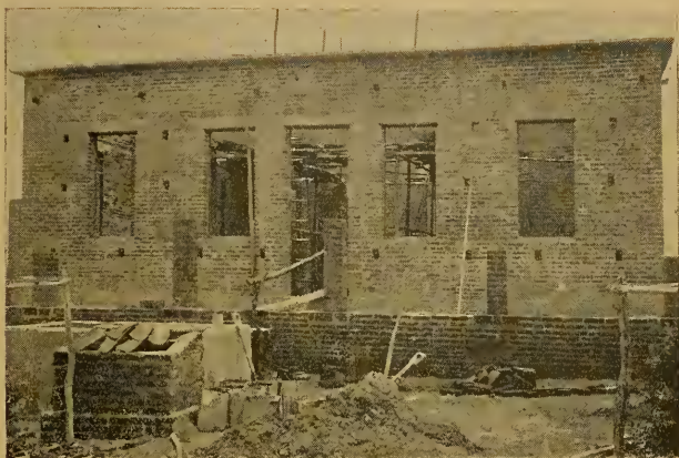
Secção de Fomento Agrícola — Estado da Paraíba — Casa de residência em construção no Campo de Sementes em Patos
